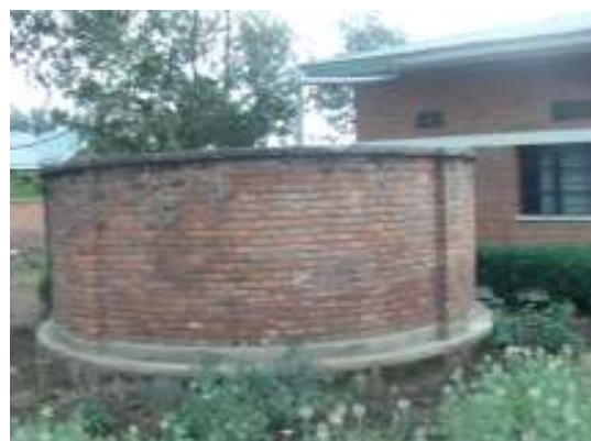
Collecte des eaux avec matériel en dur
